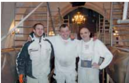
Simon, Jarl og André på 2. arbejdsdag i kirken, hvor der blev bygget stillads. Jarl Agesen i midten ejer firmaet Kalk-Jarlen.
